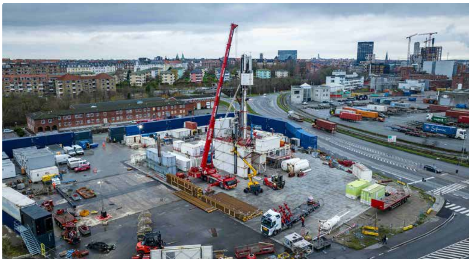
Innargi er i fuld gang med at etablere geotermi i Aarhus. Foto: Innargi.
